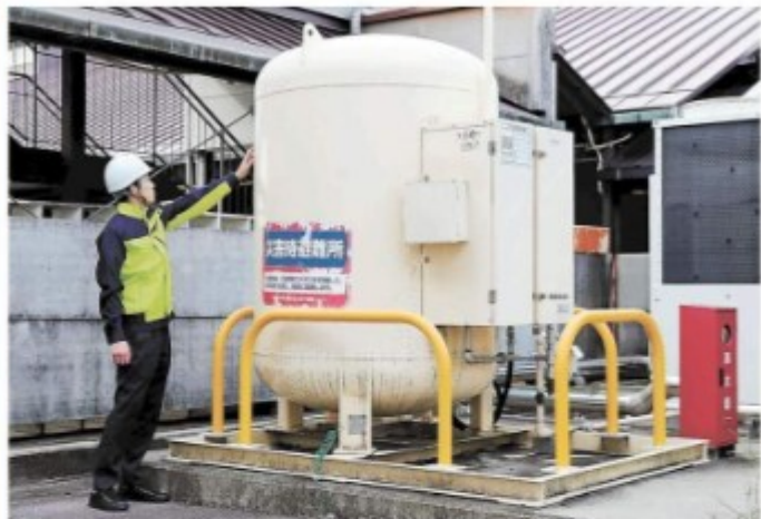
学校に設置されたLPガスタンク＝愛知県大府市（同市提供）
